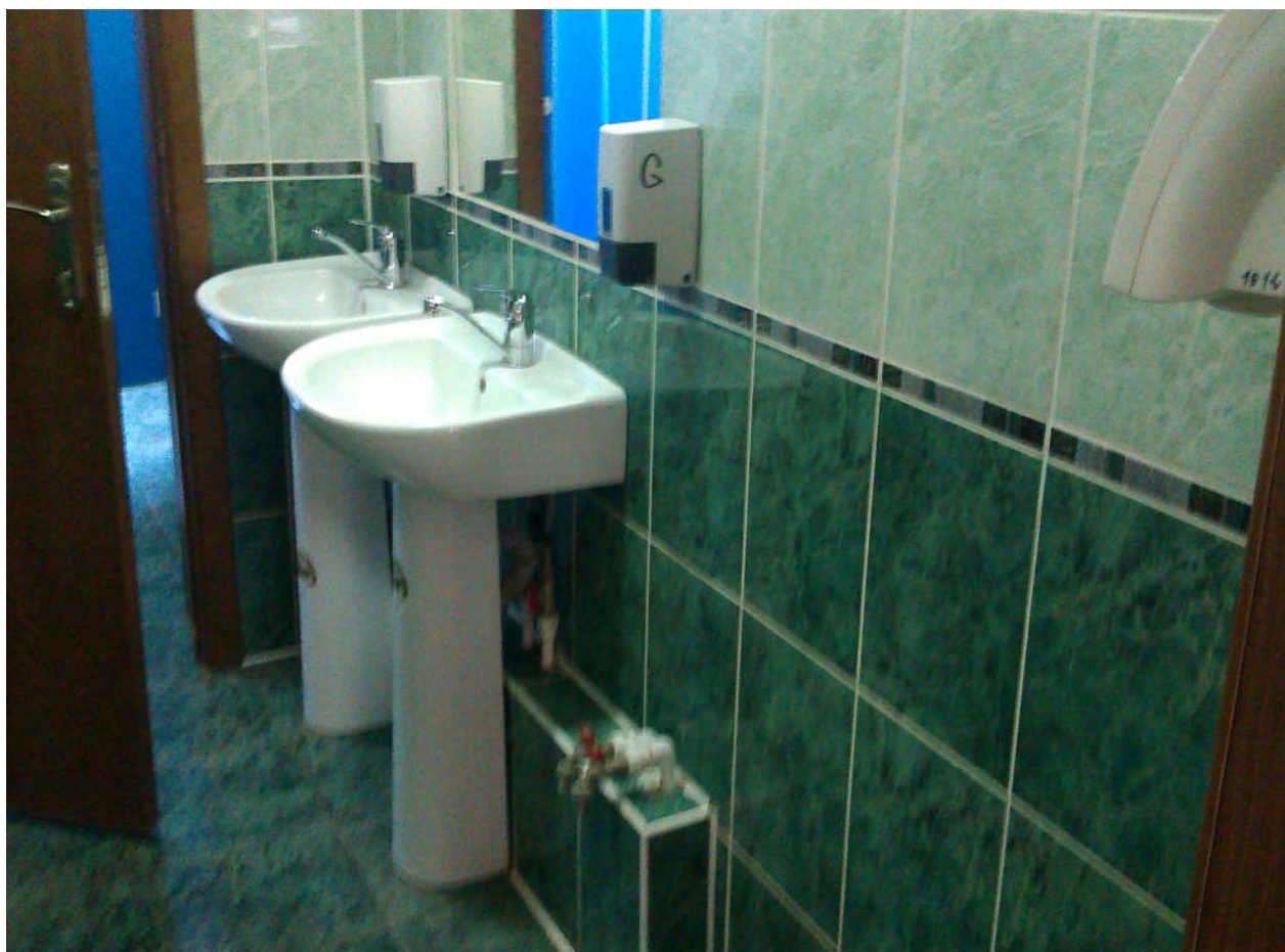
Фото № 21. Состояние доступности основных структурно-функциональных зон. Санитарно-гигиенические помещения. Туалетная комната.
